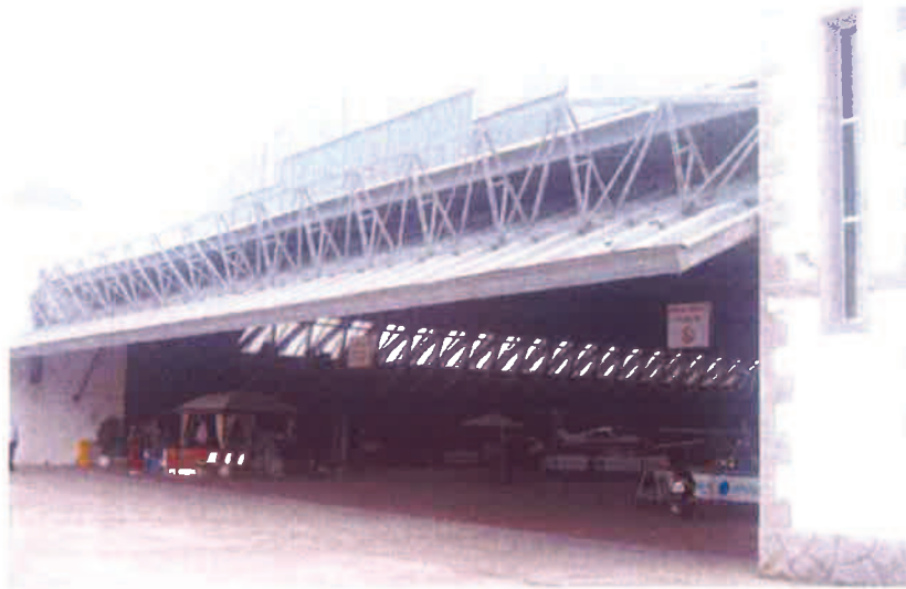
Ilustración 2: Apertura máxima de la puerta del hangar
